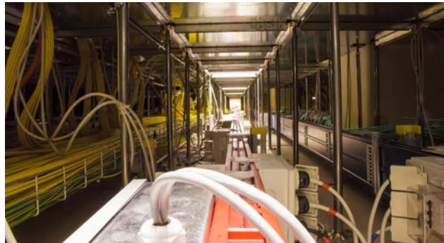
Luftzuführung, Kühlung und Kabeltrassen im Doppelboden
