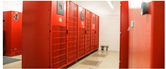
Unterbrechungsfreie Stromversorgung: USV-Anlagen (rot)
