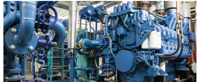
Dieselaggregate mit Notbevorratung und Nachlieferungsverträgen
