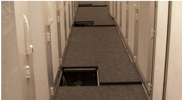
Leckage-Warnsystem: Wasserdetektoren im Doppelboden
