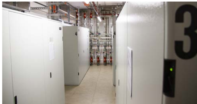
Modernste Klimasysteme mit hoher Energieeffizienz
